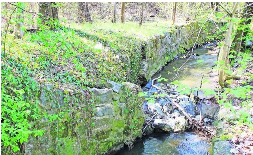
Zerstörte Ufermauer außerhalb einer bebauten Ortslage am Petersbach bei Herrnhut. Im Rahmen der Gewässerunterhaltung müssten die Mauertrümmer als Abflusshindernis aus dem Bachbett geborgen werden. Auf Wiedererrichtung der Ufermauer sollte aber verzichtet werden, da im direkten Umfeld keine wertvollen Schutzgüter zu finden sind.
